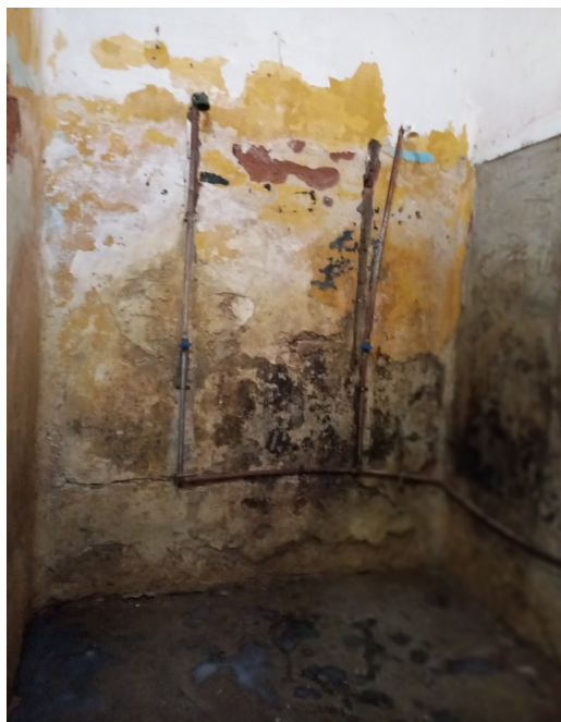
Unidad Penitenciaria Nro. 1, de Coronda, Duchas pabellón 3, Norte. Fecha : 04/04/202
